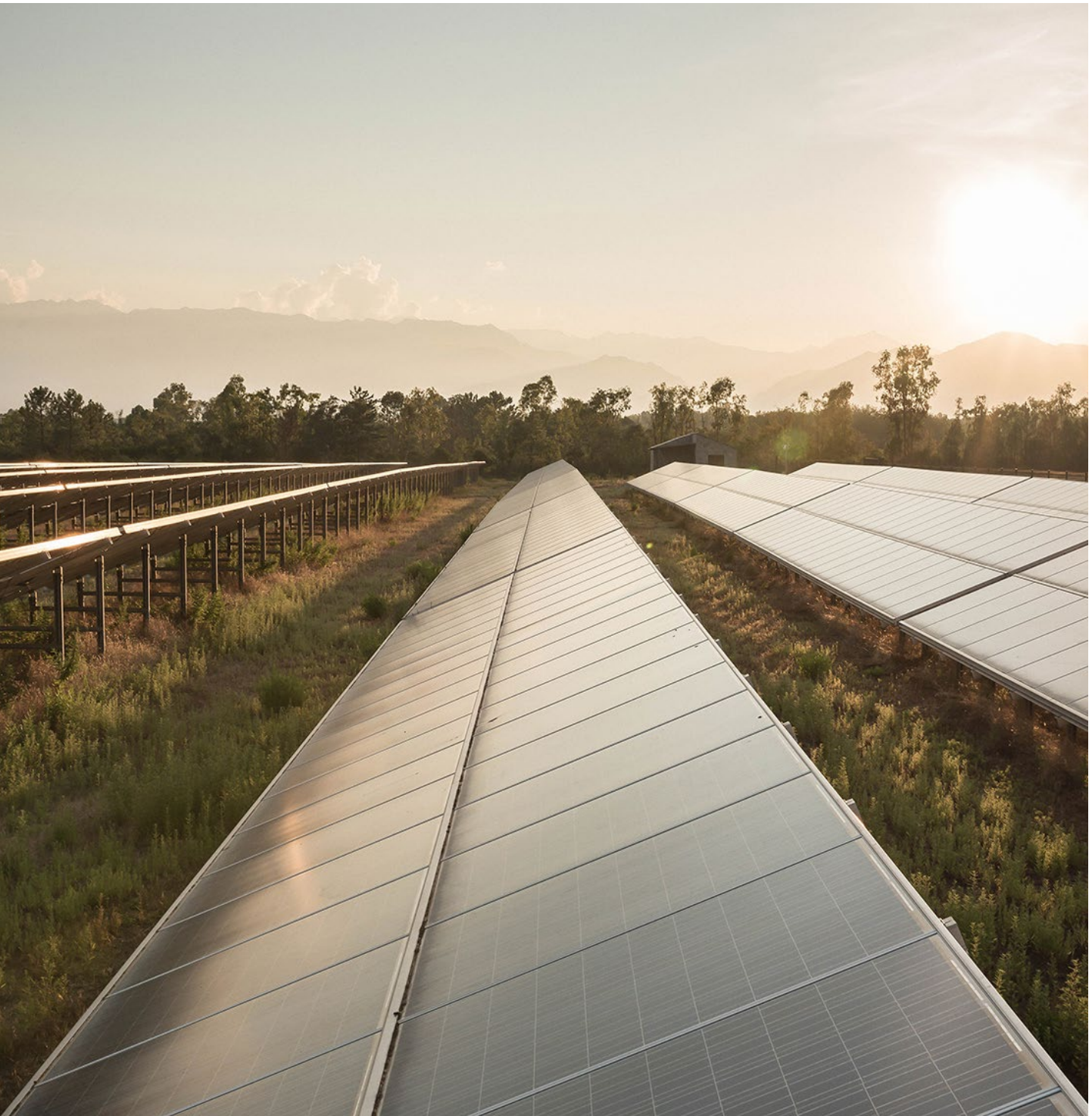
Aleria plant - Francia
