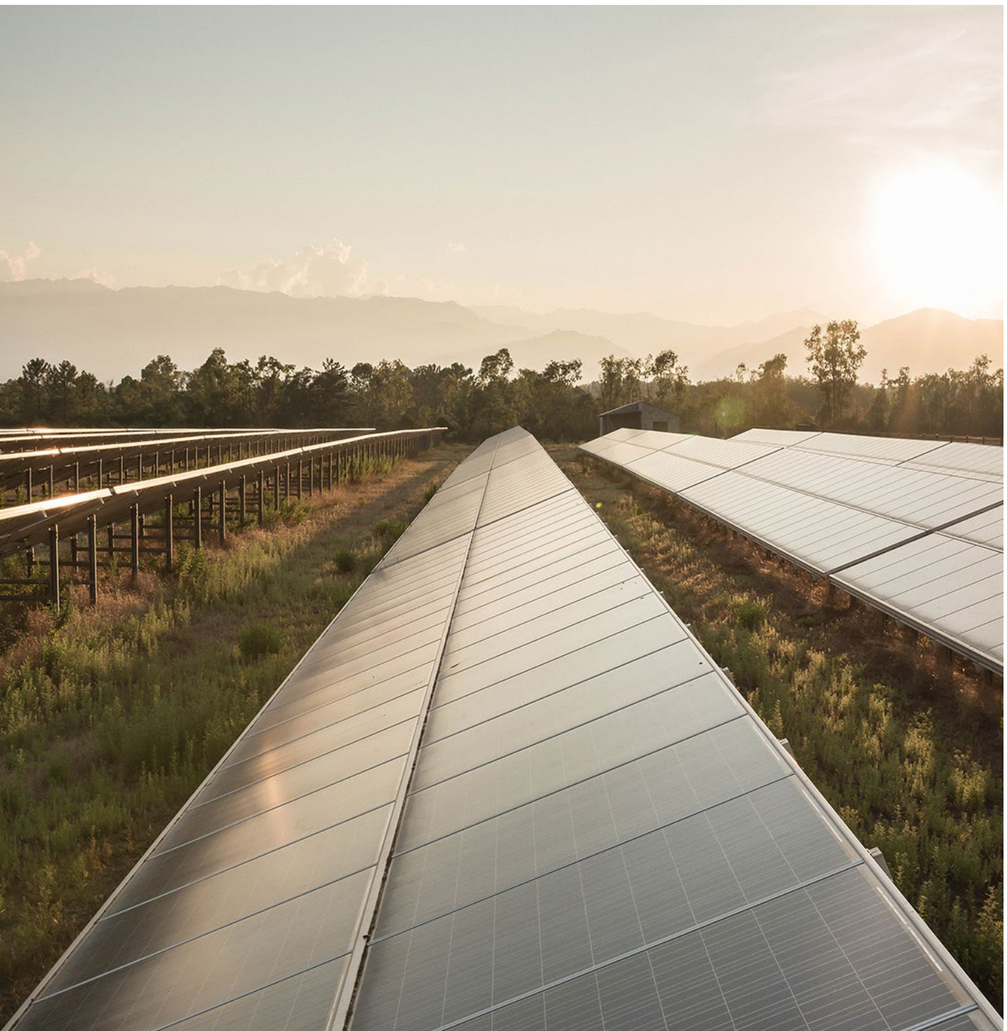
Aleria plant - Francia
