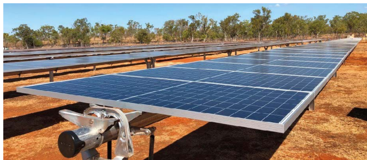
Impianto di Katherine - Australia
