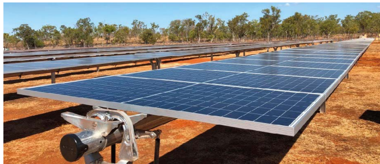
Impianto di Katherine - Australia
