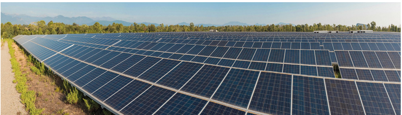
Impianto di Aleria - Francia
